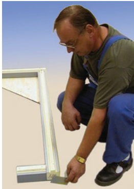
zdj. 7 Instalacja kontowników
