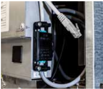
KESKUSHÄLYTYSLIITÄNTÄ RJ45 KAAPELI KYTKETTYNÄ
